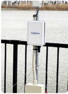
ため池監視システム (兵庫県明石市)
